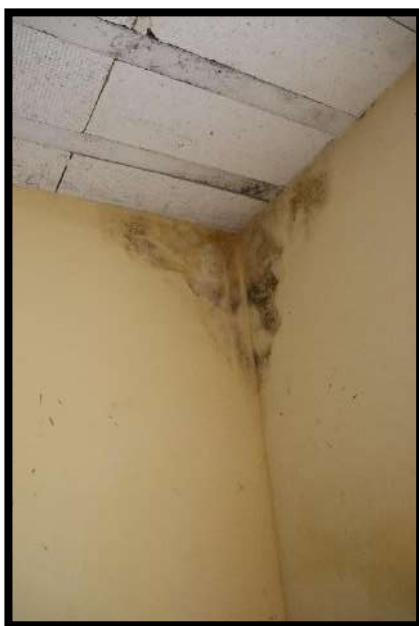
Infiltração no quarto. Fonte: Acervo MNPCT, 2024.
