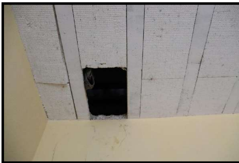
Buraco no teto do quarto. Fonte: Acervo MNPCT, 2024.
