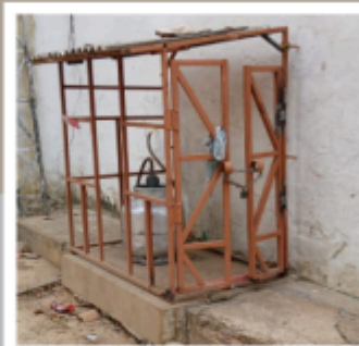
Botijão de gás instalado na parte externa
